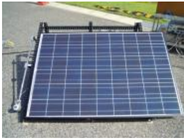
図 1 太陽光発電モジュール設置状況
