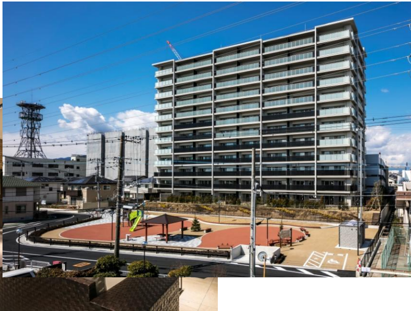
シャリエ長泉グランマックス（Ⅰ期工事部分。左側が工事中のⅡ期工事部分）
